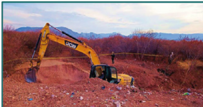
Se decide extensión de cuatro metros hacia el margen norte y se emplea la excavadora con oruga.
